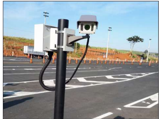
Figura 8 – Câmera de registro de passagem
